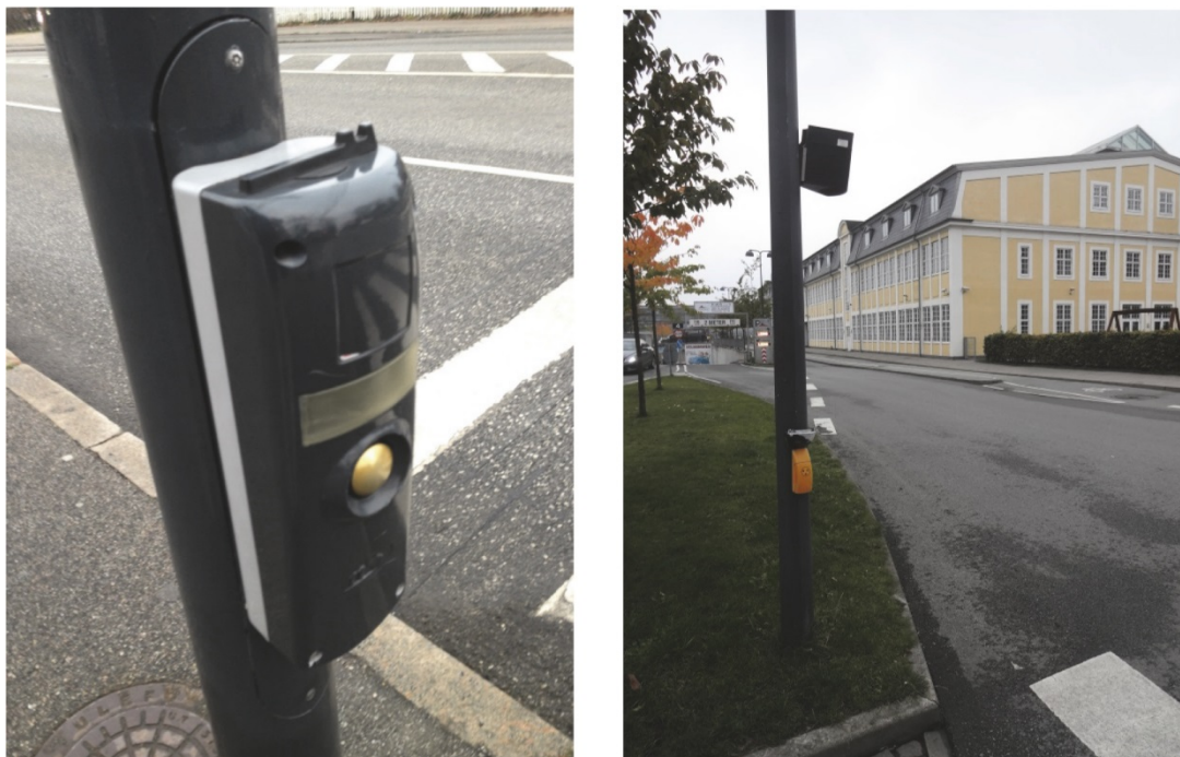
Figur 3.25 Til venstre: Eksempel på lydsignal med retningspil. Til højre: Eksempel på højt placeret lyd giver kombineret med retningspil med pilottone. (Valby Langgade, København)
